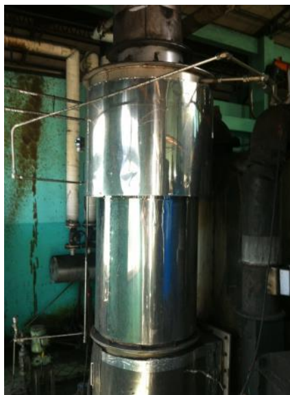
鍋爐氫氣助燃系統
