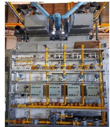
Heat regenerative combustion furnace 第二期能源國家型科技計畫 National Energy Program-Phase II
