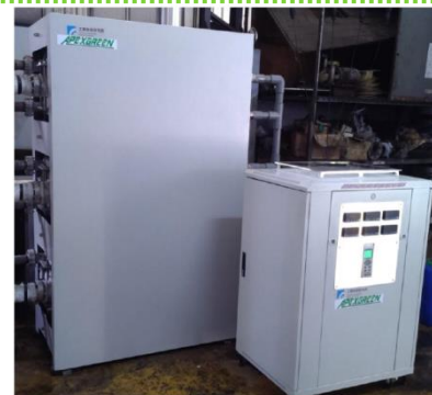
熱電發電系統(1KW)
