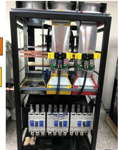
350 kW 機櫃裝置
